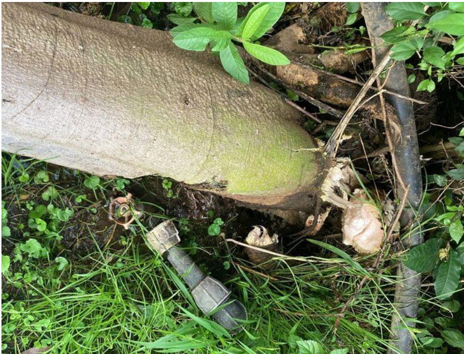
Kuva: Papaijapuun runko kaatuneena vesijohtojen päälle
