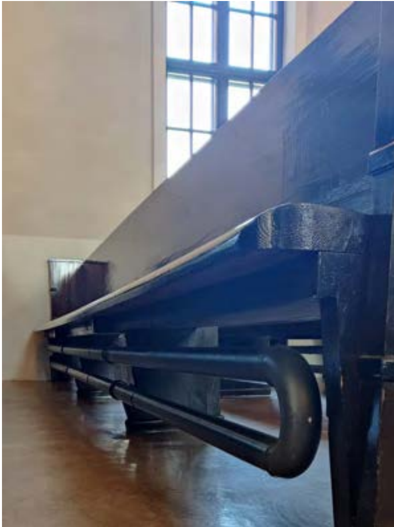
Kuva kirkkosalin penkkien alla sijaitsevista teräsputkipattereista
