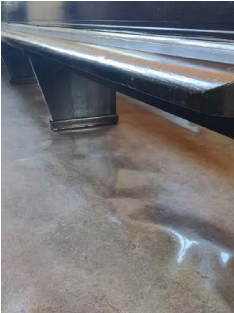
Kirkossa vuosina 1996 ja 2003 suoritetuissa kosteuskartoituksissa havaittiin kirkkosalin lattiapinnan kupruilua ja lattiamateriaalin irtoamista alustastaan
