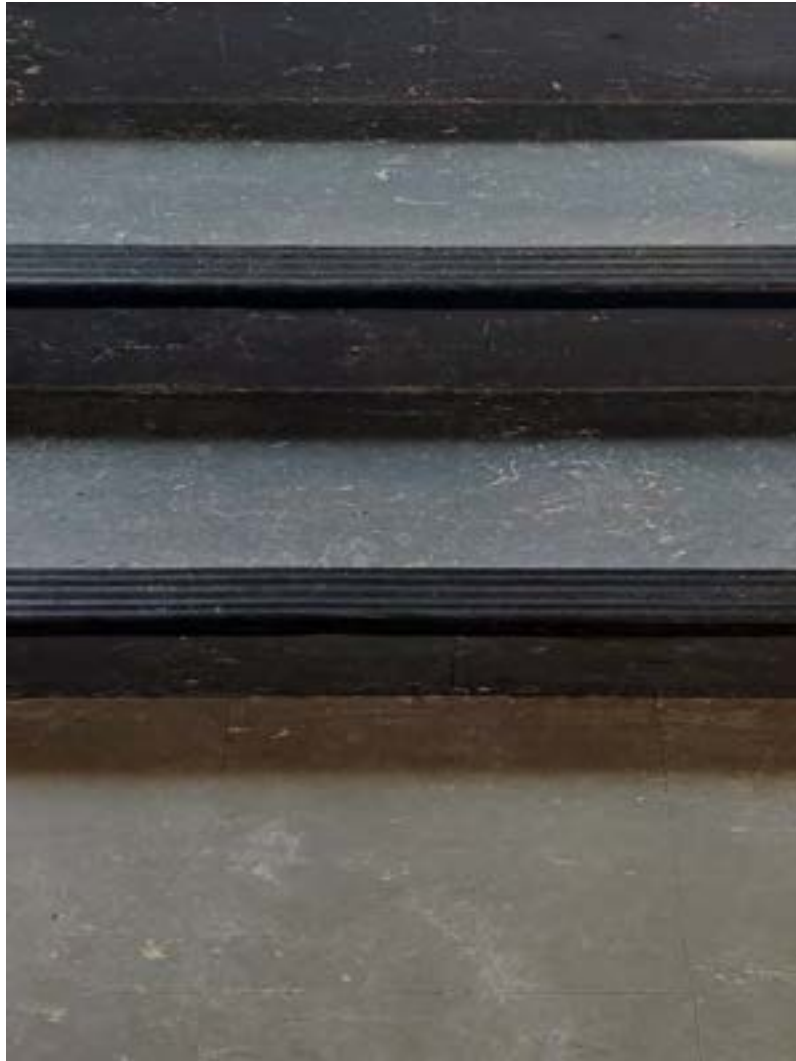
Altarikorokkeen huopamatto poistettiin ja alttarille sekä alttarin ja kirkkosalin etummaisien penkkirivin väliseen osuuteen asennettiin kumilaatat
