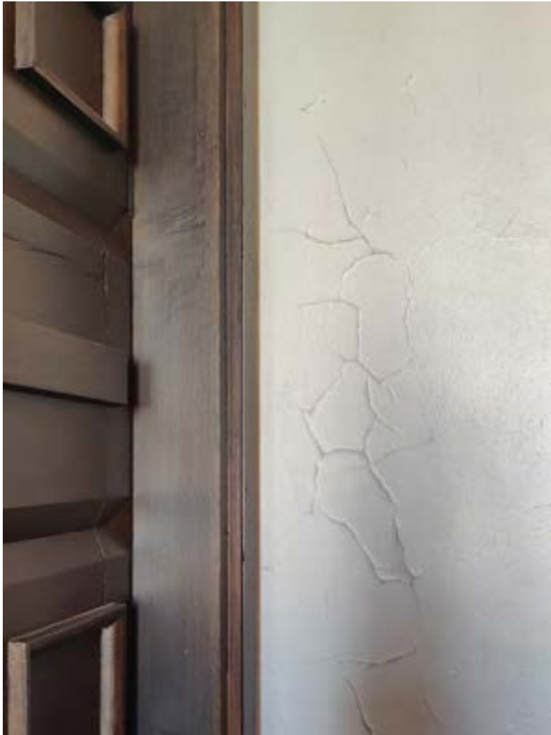
Kirkon rapatut sisäseinäpinnat on korjattu ja huoltomaalattu edellisen kerran sisätulojen saneerauksen yhteydessä 1985
