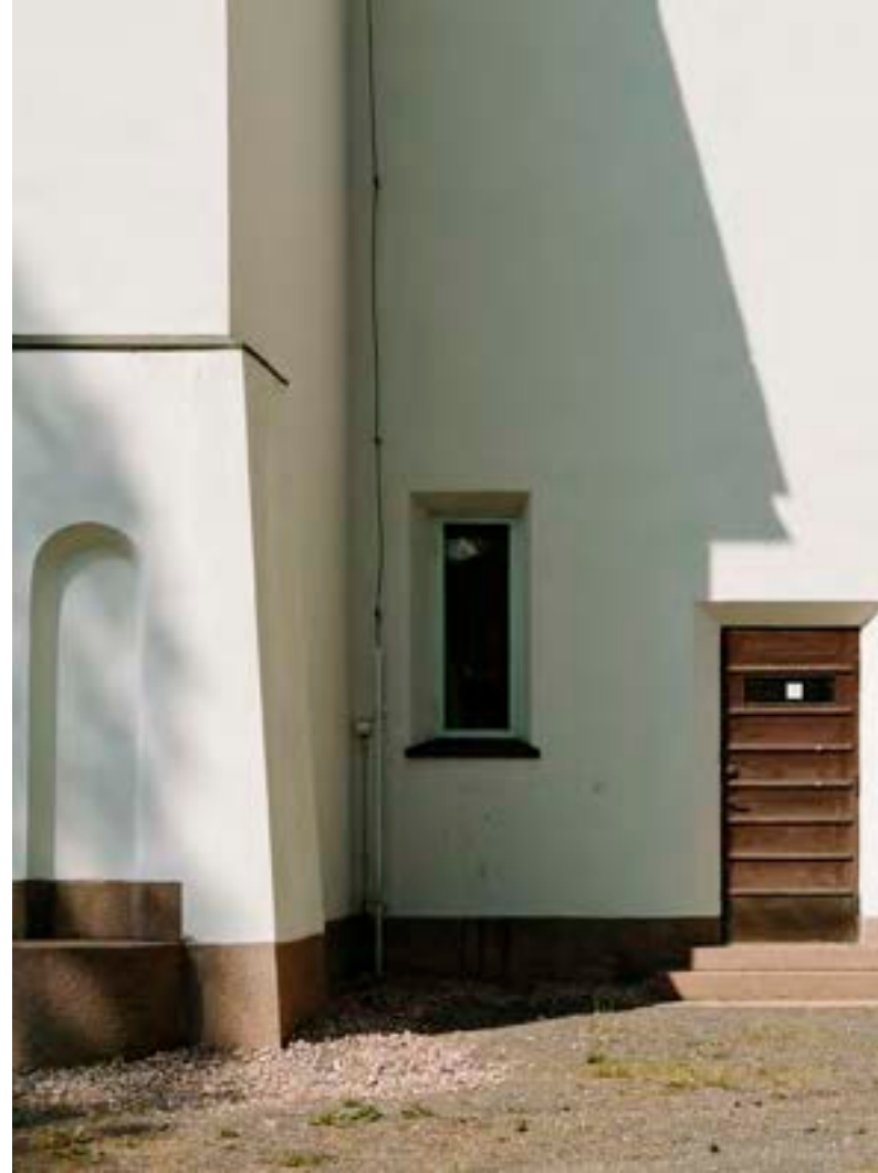
Halkeamat rappauspinnoissa korjattiin ja maalattiin, portaiden ja sokkeleiden irronneet saumat uusittiin sekä ovet ja ikkunat kunnostettiin vuoden 1985 peruskorjauksessa
