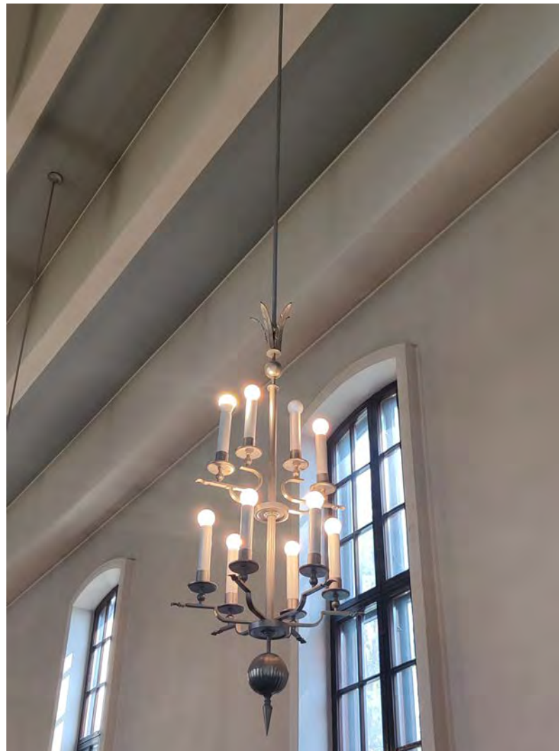
Kirkon rapatuissa ja vaaleiksi maalatuissa katto- ja seinäpintoissa on havaittavissa lämpökanavan nokionnettomuuden jäljiltä pintoihin jäänyttä likaa
