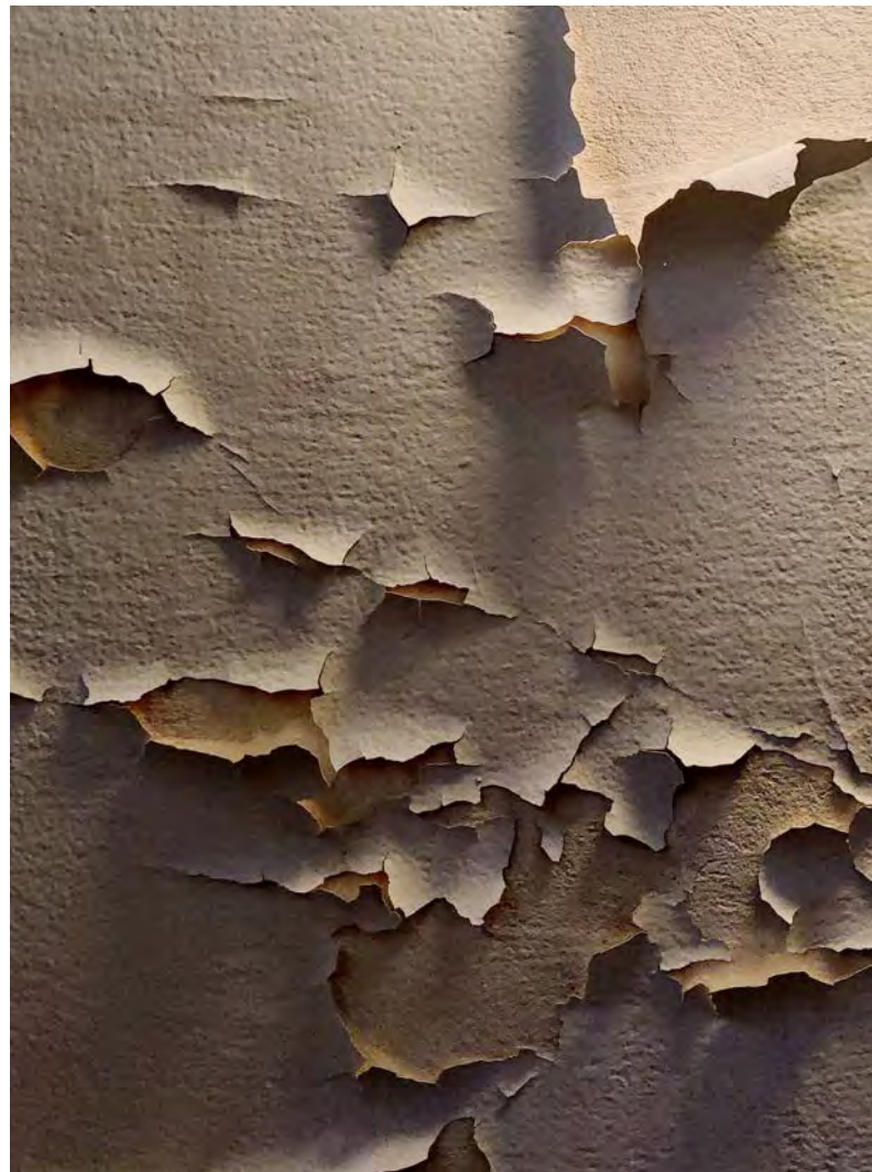
Eteistilan kattopinnat hilseilevät alustastaan isoina paloina
