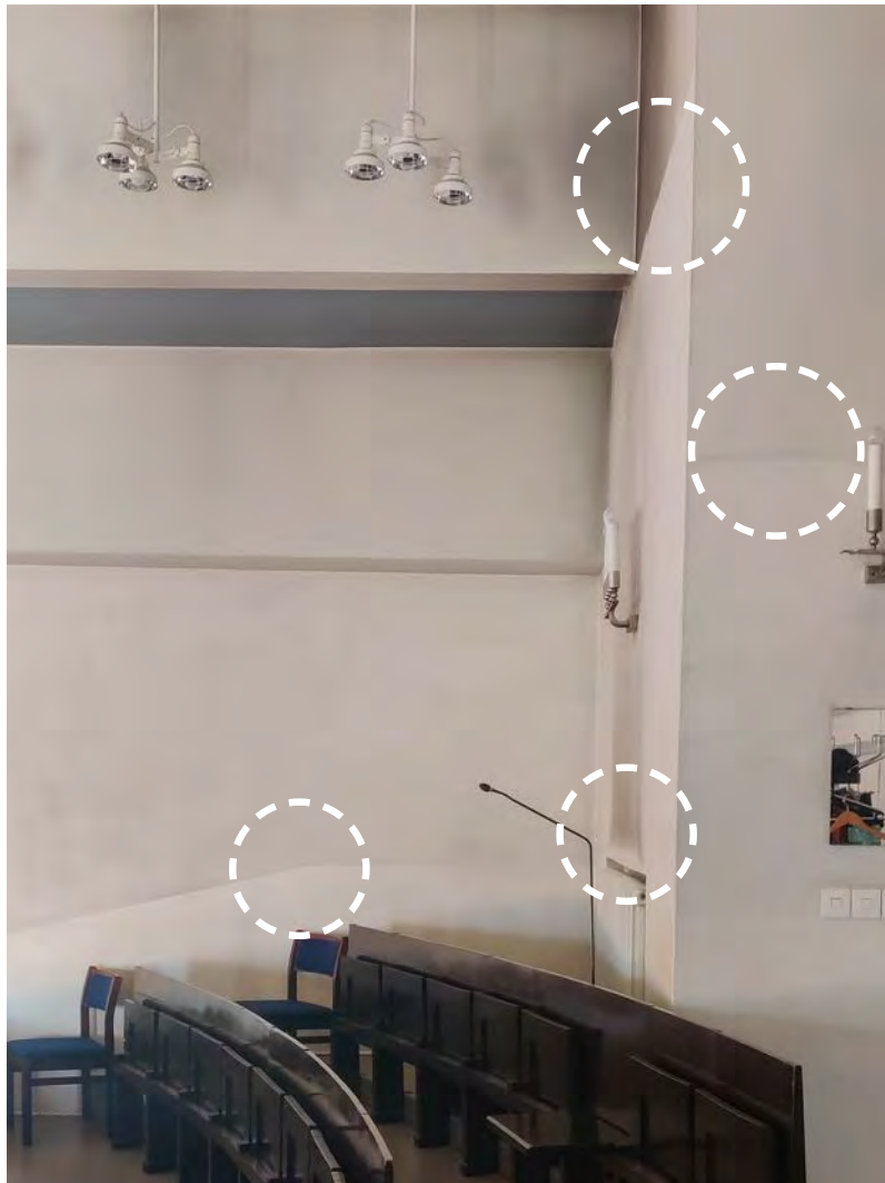
Urkulehterillä toisistaan erottuvia maalipintoja sekä noen ja pölyn likaamia kohtia seinissä
